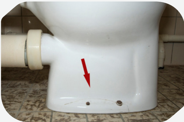
Scheur in toilet
