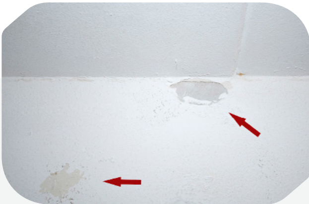
Verf of stucwerk laat los
