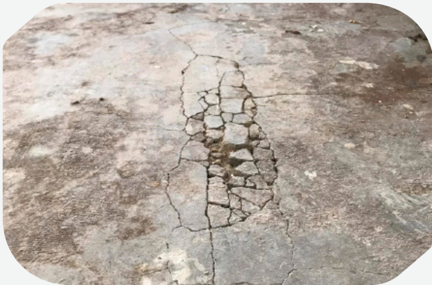
Scheur in vloer
