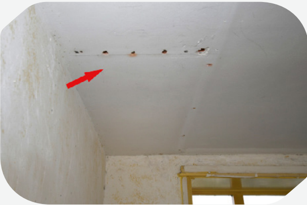
Gaten in het plafond
