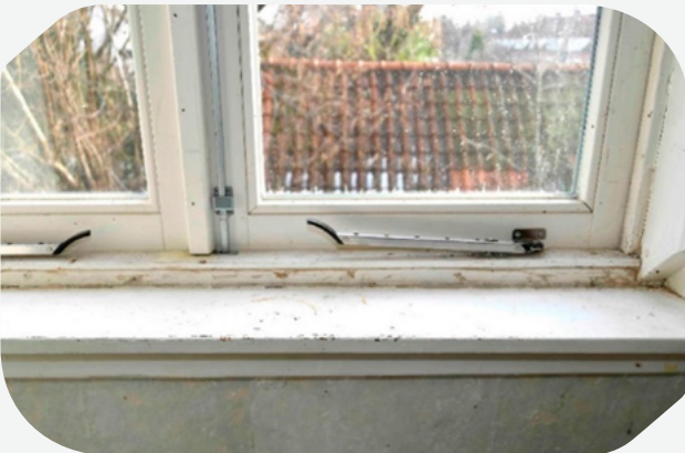
Onderkant van kozijn aangetast door vocht
