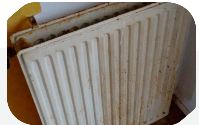
Aanslag en roest (niet meer te herstellen)
