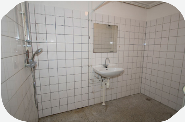
Badkamer niet goed schoongemaakt
