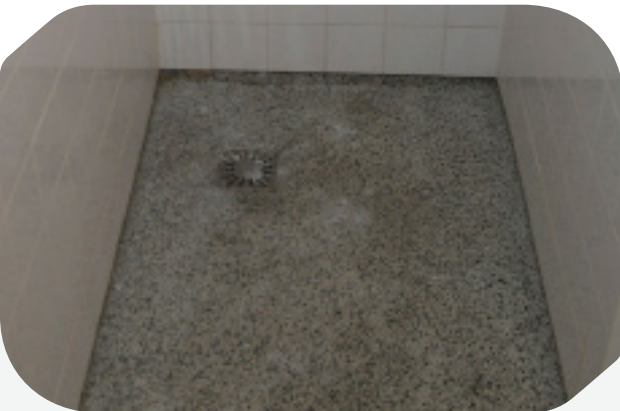
Kalkaanslag op de vloer
