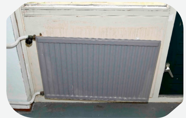
Radiator niet goed bevestigd
