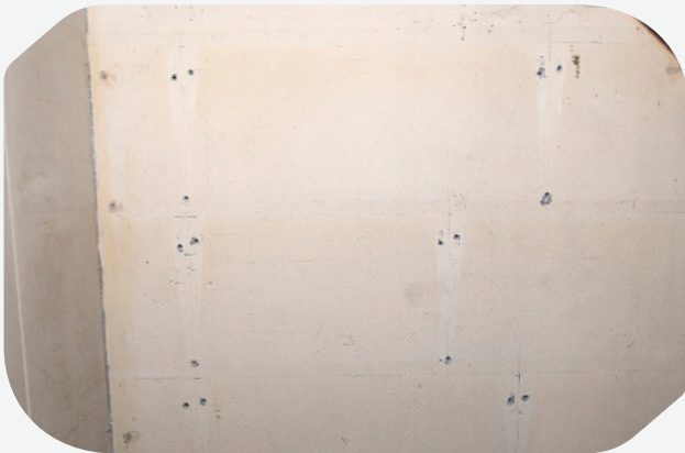
Boorgaten in de muur
