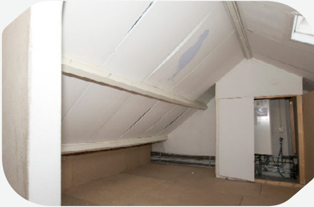
Plafondplaten sluiten niet goed aan
