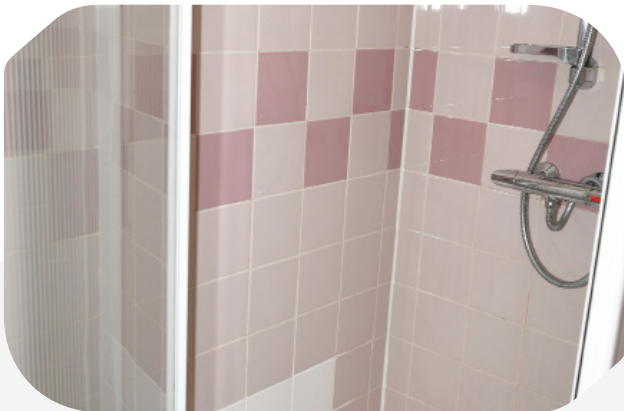
Kleurverschil in de tegels en voegwerk
