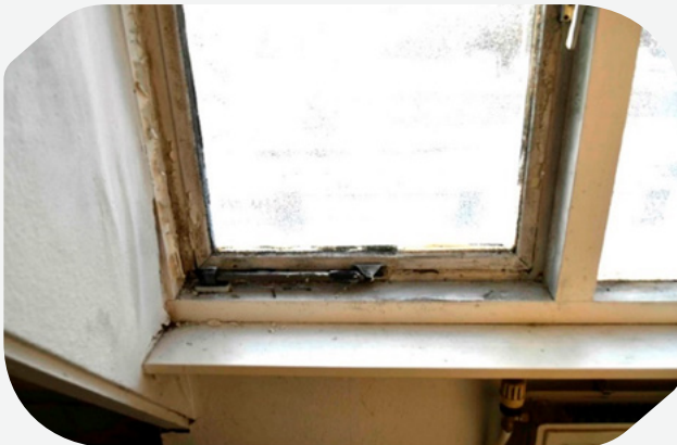
Beschadigde onderkant kozijn
