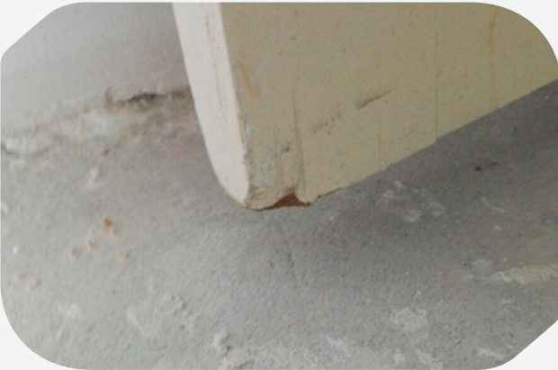
Onderkant van deur aangetast door vocht
