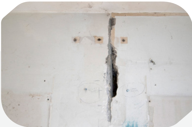
Gaten in de muur
