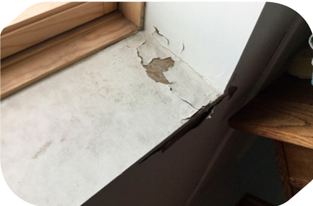
Houtwerk beschadigd door vocht (herstelschade)
