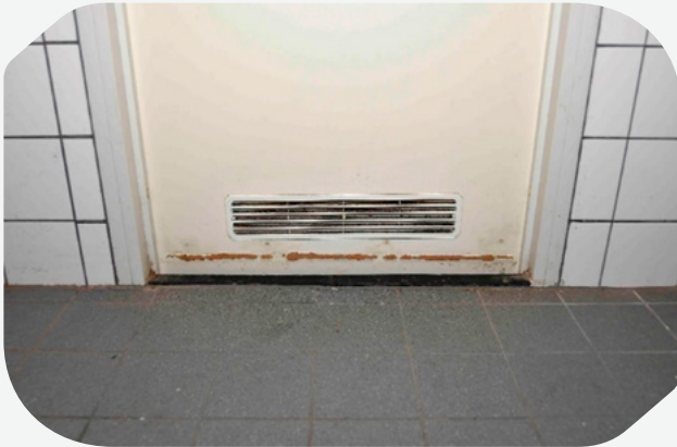
Beschadigde onderkant deur
