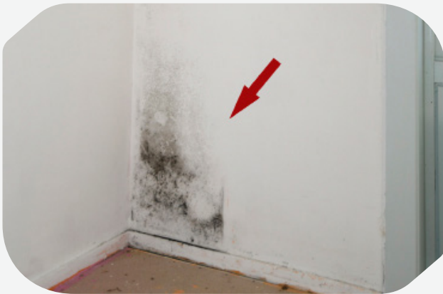
Schimmel op de muur
