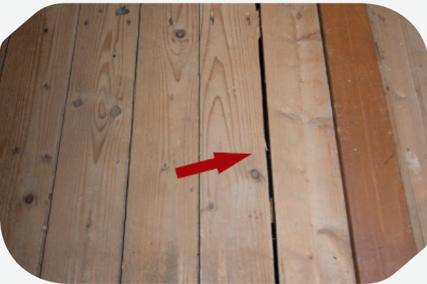
Naad in houten vloer
